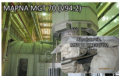
شکل ۷- محل نصب سنسور ویبره مطلق (Absolute Vibration) توربین گازی (V94.2) MGT 70
